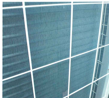
散水1ヵ月後フィン表面に変化なし
